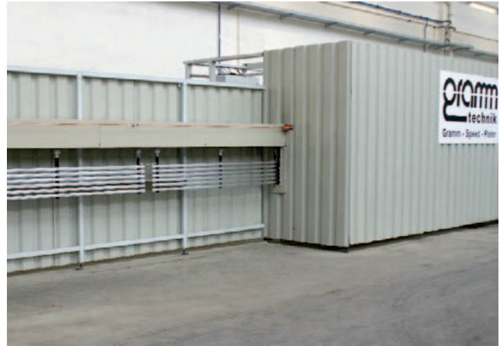
GSP-Anlage: Vollautomatische Galvanisierung im geschlossenen System
